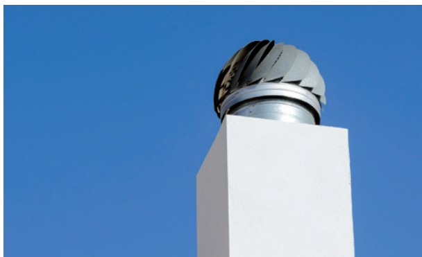
Extracteur de fumée en sortie de conduit.
